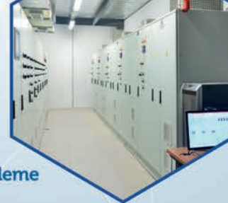
Elektrik ve Otomasyon Merkezi
